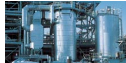
▲ Die Modulheizanlage für die norwegische Bohrinselform «Heimdal» in der Nordsee. Leistung: 10,5 MW bei 300 °C.
